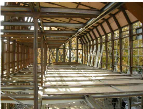
Vue du R+1 – portiques en tôle pliée Indaten
